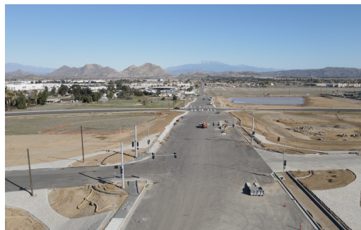
Luces de la intersección instaladas en la rampa de entrada y salida de la I-215 hacia el norte y Placentia Ave.
