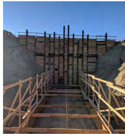
Se están construyendo dos cruces de vida silvestre para proveer un paso seguro para los animales debajo de la carretera.
